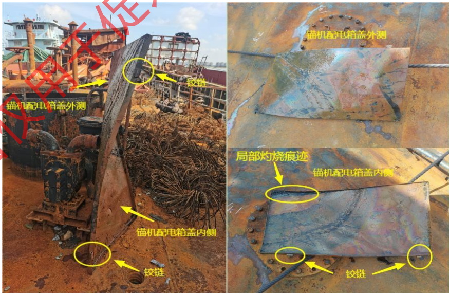
图 7：锚机配电箱盖照片
