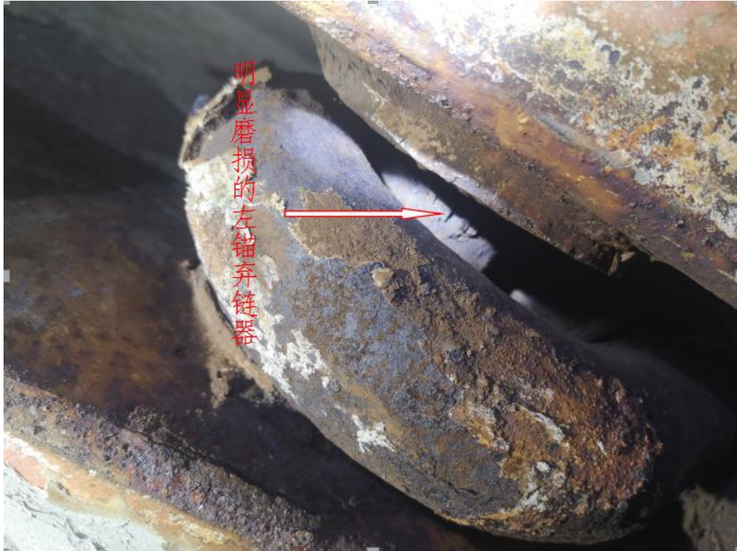
图 7：左锚链舱弃链器磨损情况
