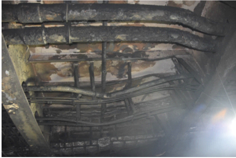
图16.车厢尾部对应船舱顶部管网烧损变形情况
