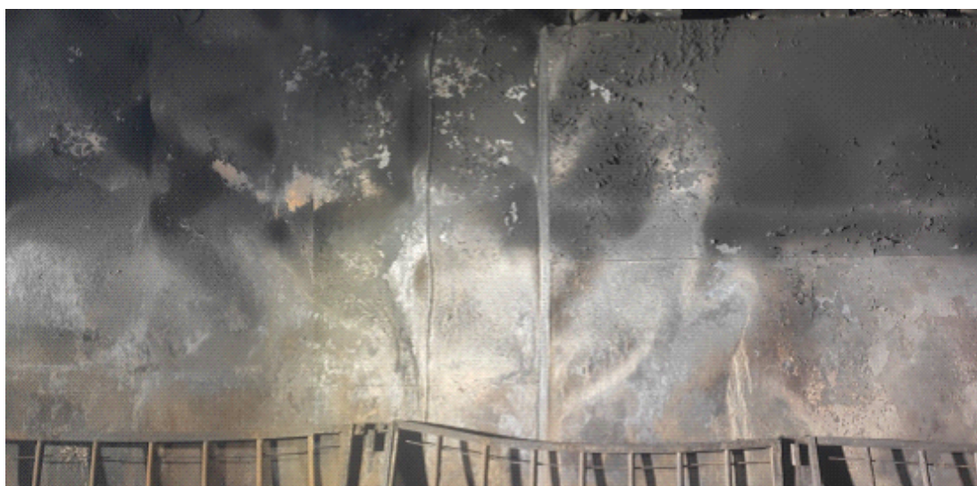
图12.“辽 F6707挂”左侧机舱壁烧损变形情况
