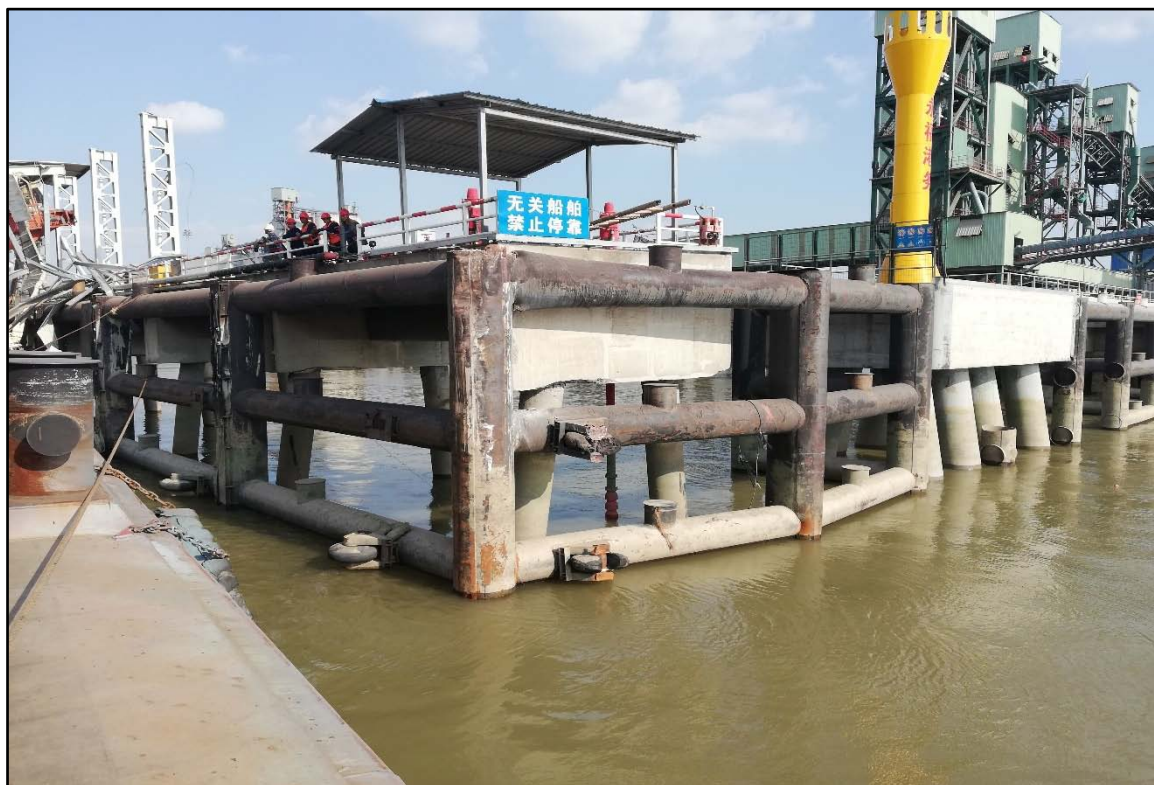
图 13: A 码头受损情况
