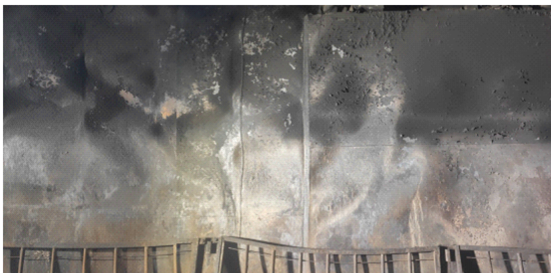
图12.“辽 F6707挂”左侧机舱壁烧损变形情况
