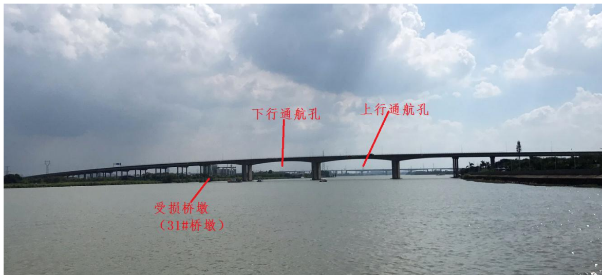
图 12：受损桥墩位置情况
