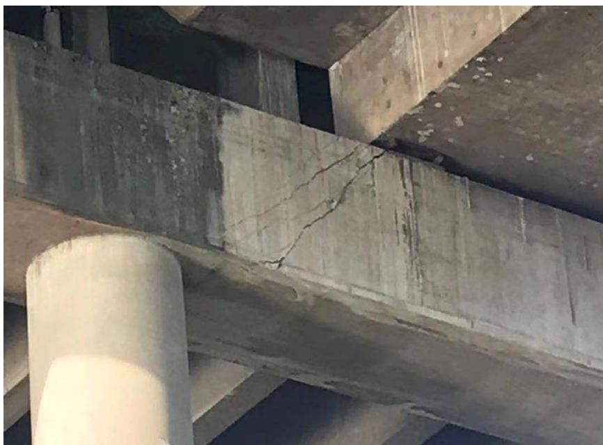
图 14：31#桥墩横梁裂缝情况
