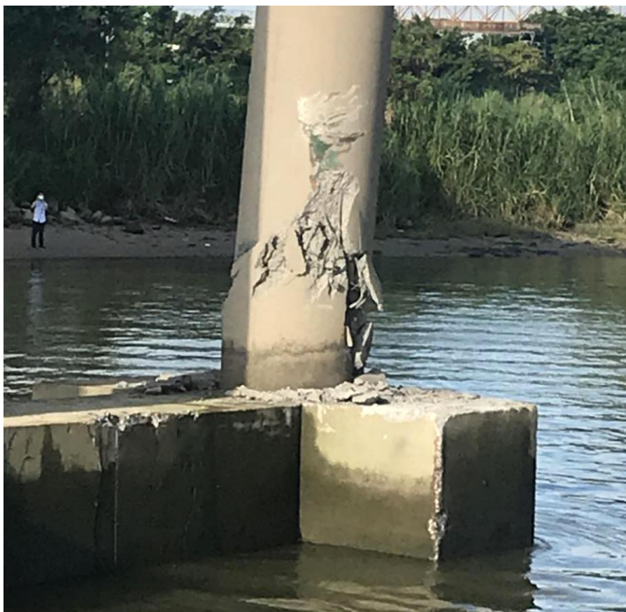
图 13：31#桥墩立柱受损情况
