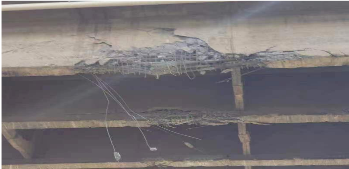
图 12：南头大桥旧桥损坏情况
