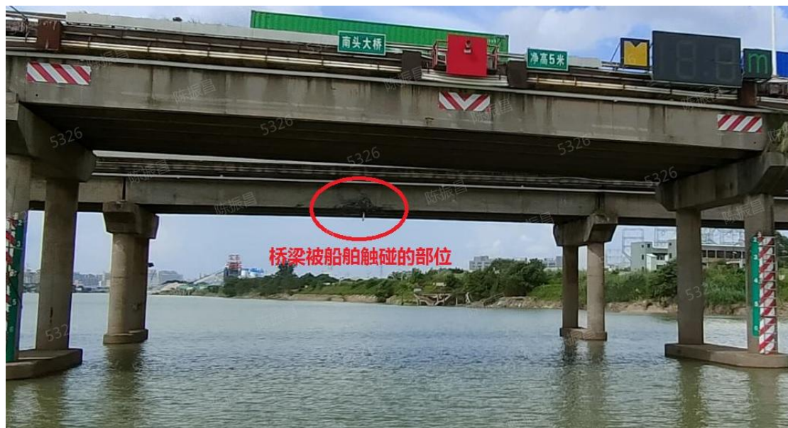
图 11：南头大桥被“粤清远工 6829”船触碰的部位
