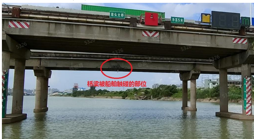
图 7：南头大桥被“粤清远工 6829” 船触碰的部位
