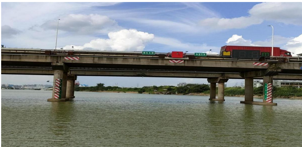
图 3：南头大桥桥梁警示标示
