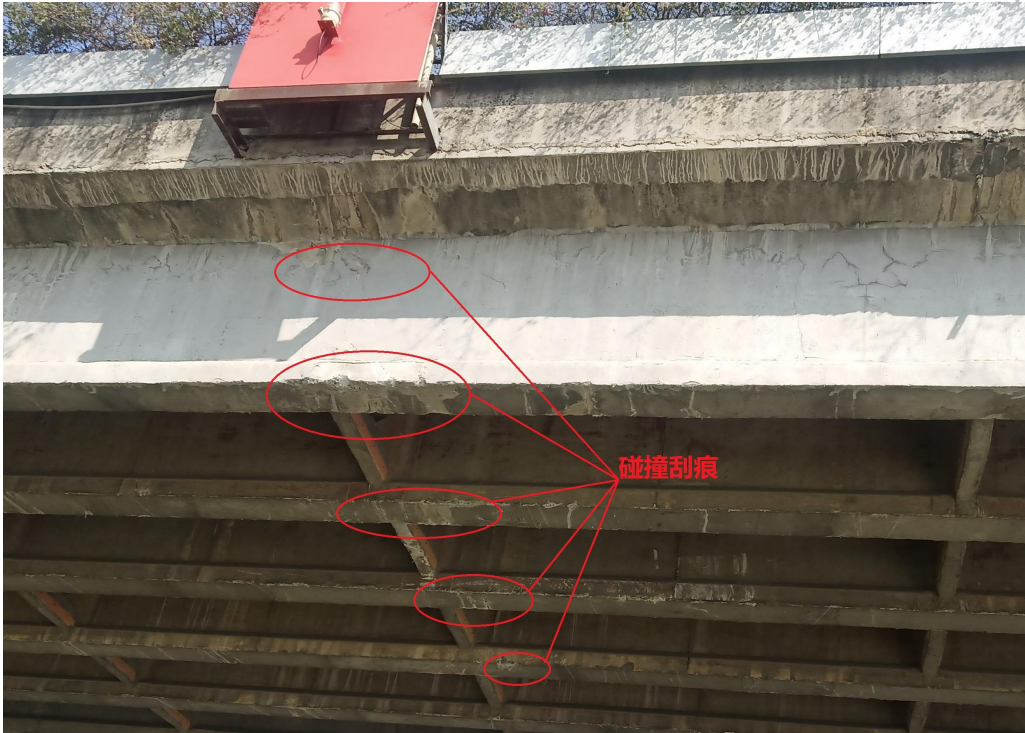
图6：丰岗大桥受损情况
