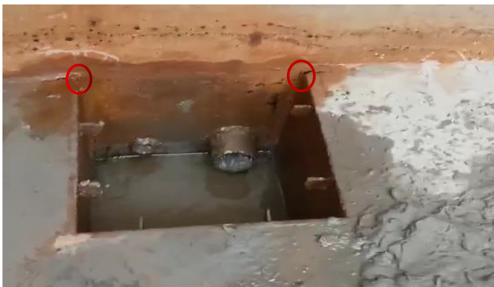
图25: “海之运918”轮货舱尾部污水井裂缝的照片
