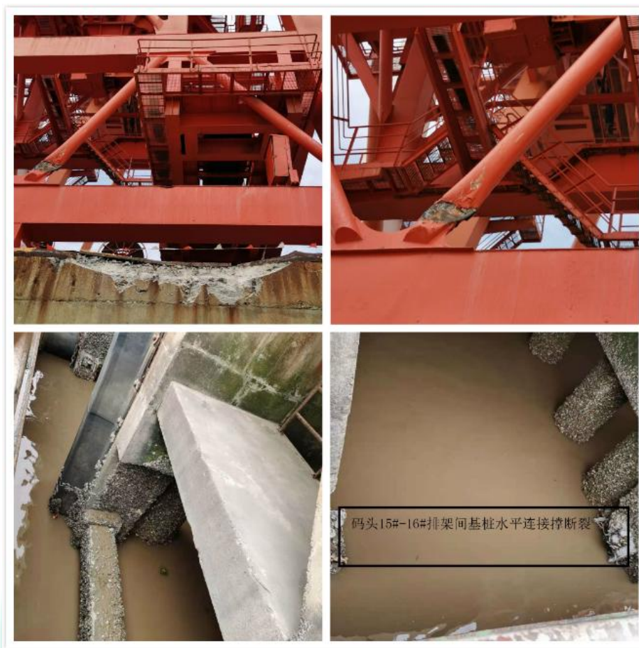
图 8/9/10/11：码头损失情况照片
