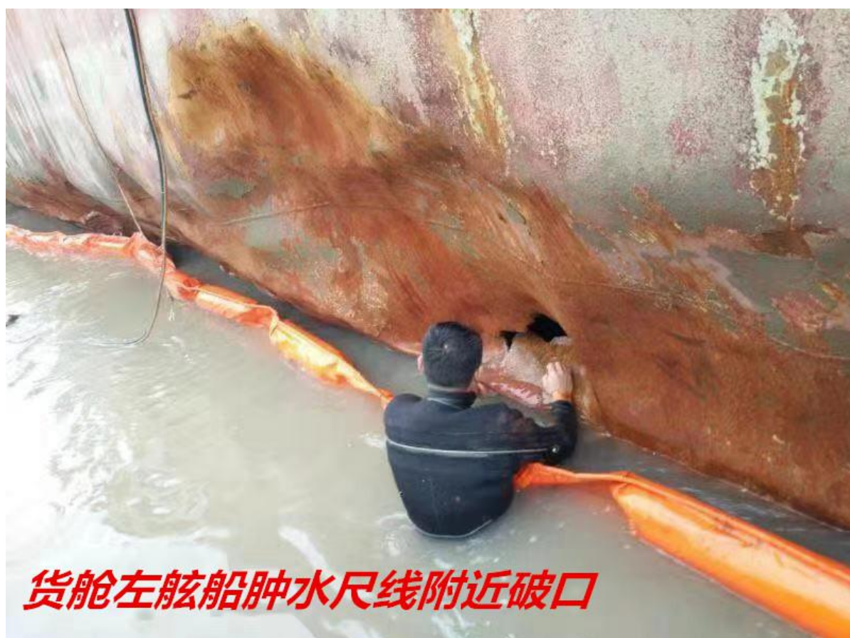
图 1: “YC1” 轮破损位置照片
