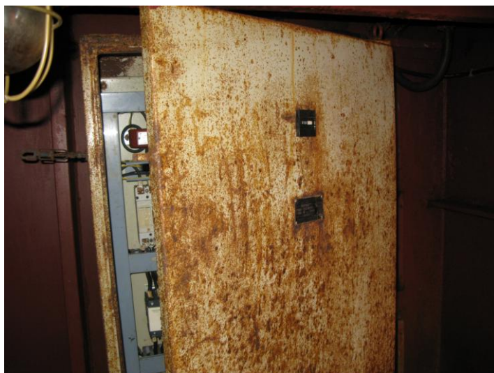
图5：舱室内绞缆机配电箱照片
